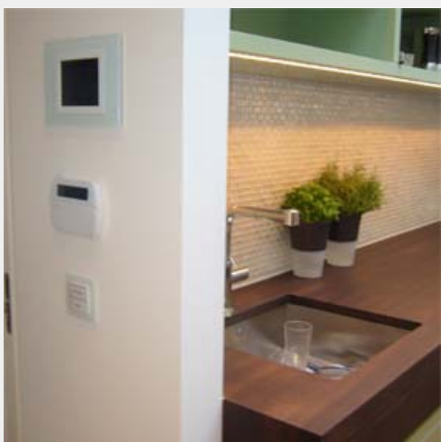
Thommessensvei 8, Bærum KNX-prosjekt, privatbolig
